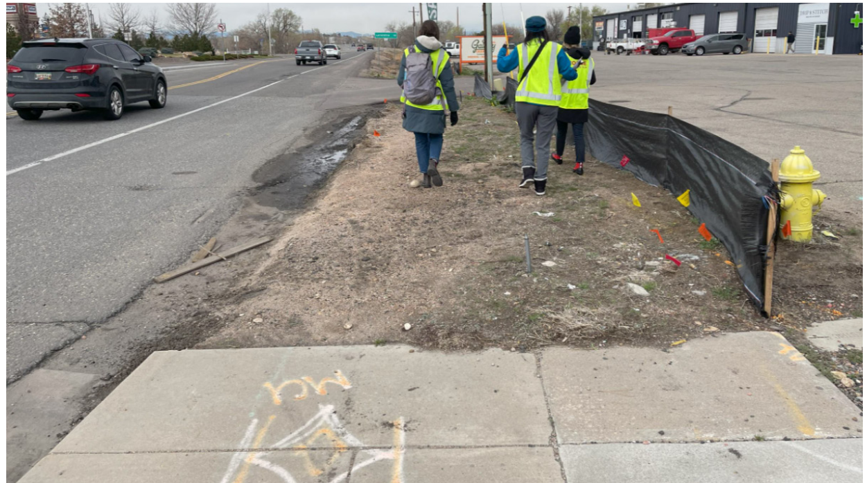
Figura 1. Condiciones Deficientes y Faltantes de Aceras a lo Largo de Bridge Street
